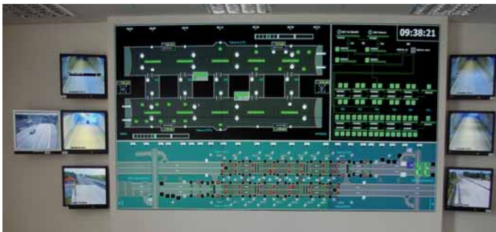
Pohled do řídicího centra 1 (ŘSD – SSÚD Ostrava).
